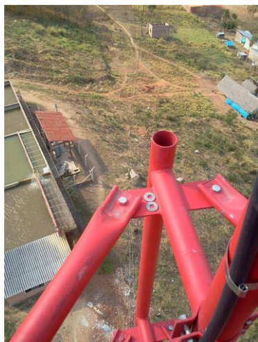
Soportes Antenas MW
